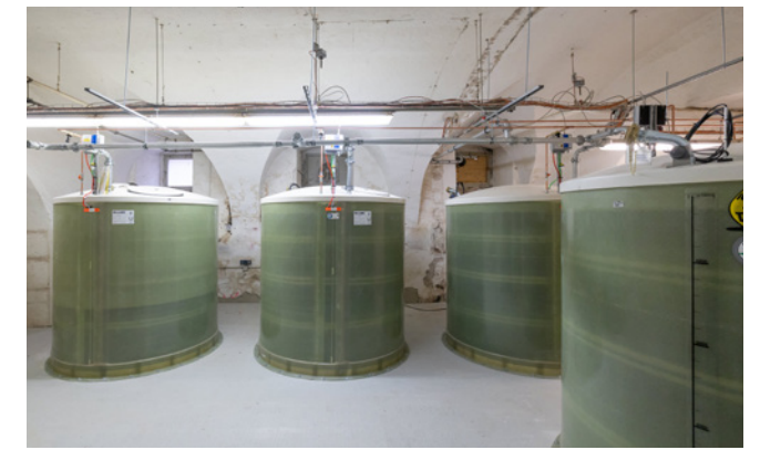
Platz ist im Lagerraum für zwei weitere baugleiche Tanks. Alle Behälter sind Green-Fuels-ready.
